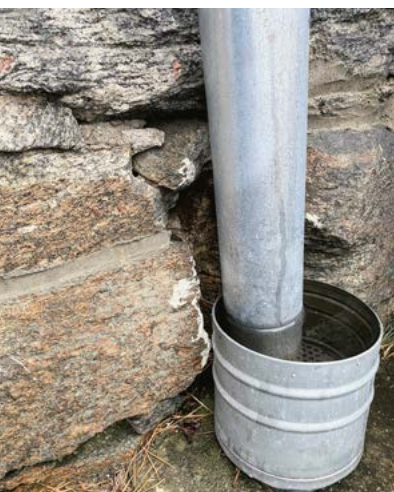
Nedløpsvann i "sluk" med rist.
