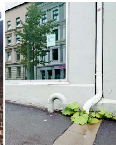
Ivrig vegetasjon på steder med jevn fuktighet
