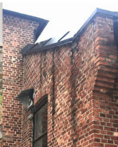
Fuktstriper på mur tyder på utette beslag
