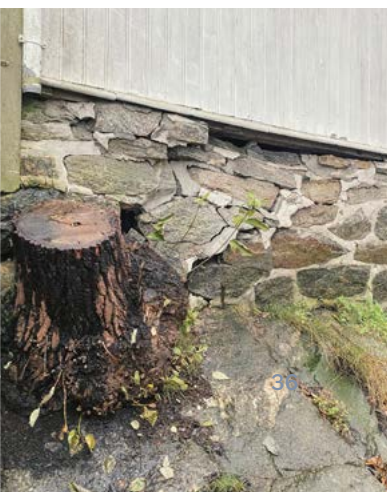
Røtter liker seg i fuktige sprekker og kan sprengne mur
