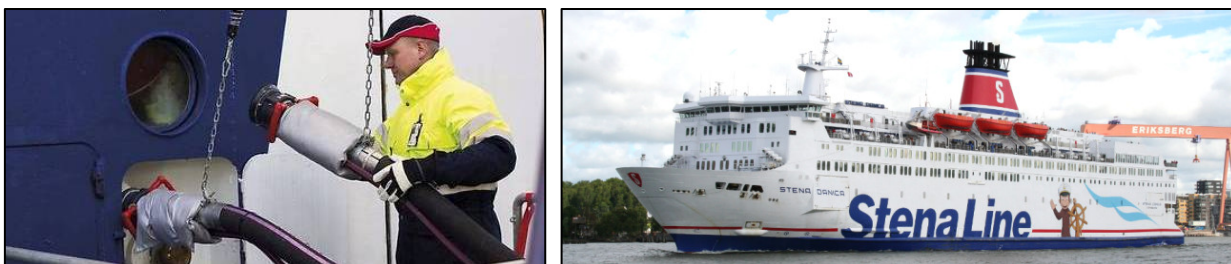
Figur 9-14: Tilkobling av fjernvarmeløsningen på «Stena Danica» ved kailigge for å erstatte dieselbruk på oljefyrte kjeler (Norsk Fjernvarme, 2018).
