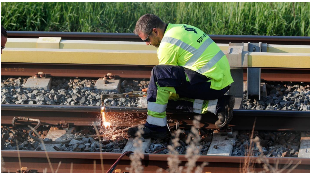
Bilde 13 Solslyng. For å hindre solslyng måtte vedlikeholdsarbeidere rykke ut for å skjære bort biter av t-baneskinnene ved fire punkter mellom Godlia og Hellerud 29. mai 2018. Foto: Olav Olsen/ Aftenposten.
