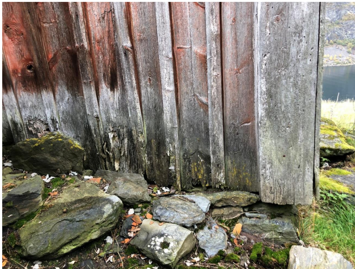
Bilde 8 Råte vil bli et større problem i Oslo som følge av klimaendringene. Foto: Guro Sørnes Kjerschow/ Oslo kommune, Klimaetaten.
