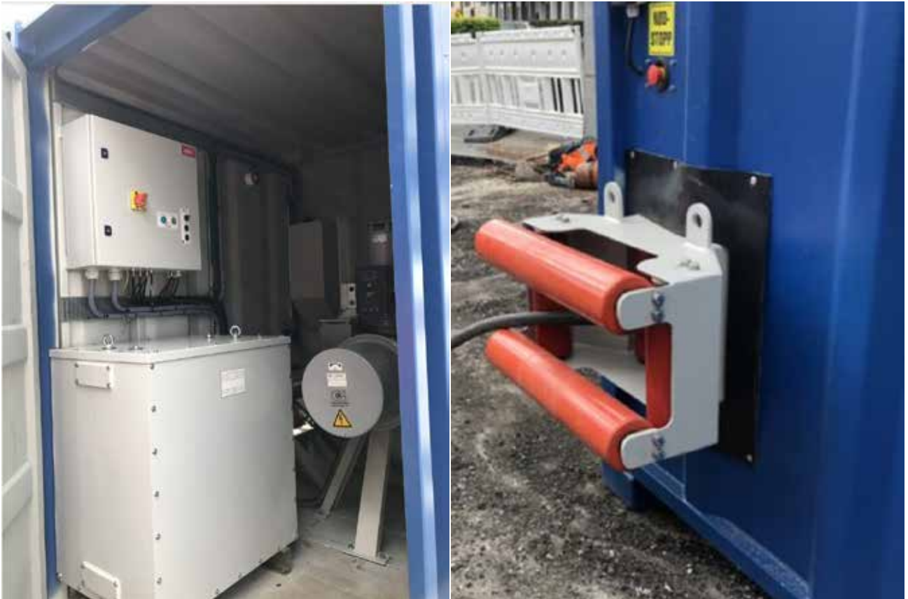
Figur 10 Container med skilletrafo og ladekabel med trommelløsning for automatisk inn-/uttrekk av kabel
